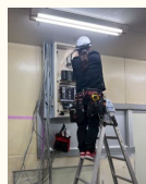
分電盤設置状況
